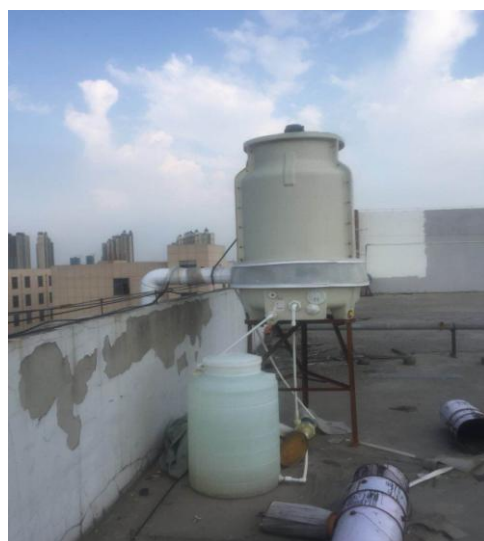
腐蚀废气处理装置
